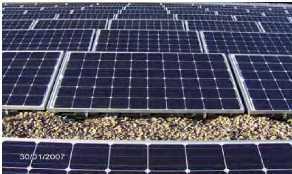
Foto 41. Campo Fotovoltaico nº 1.
