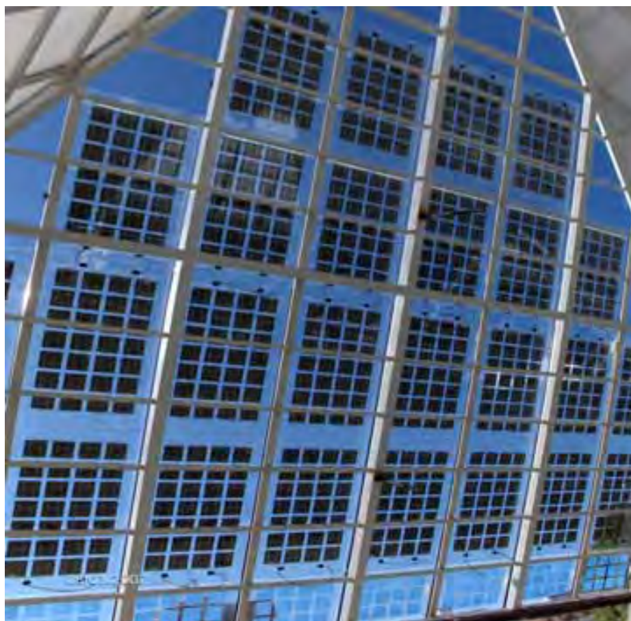
Foto 42. Campo Fotovoltaico nº 2.
