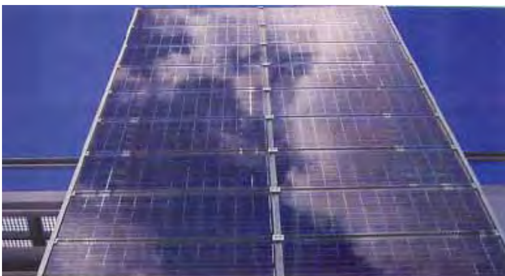
Foto 36. Paneles fotovoltaicos en la fachada del edificio de la Fundación Metrópoli.
