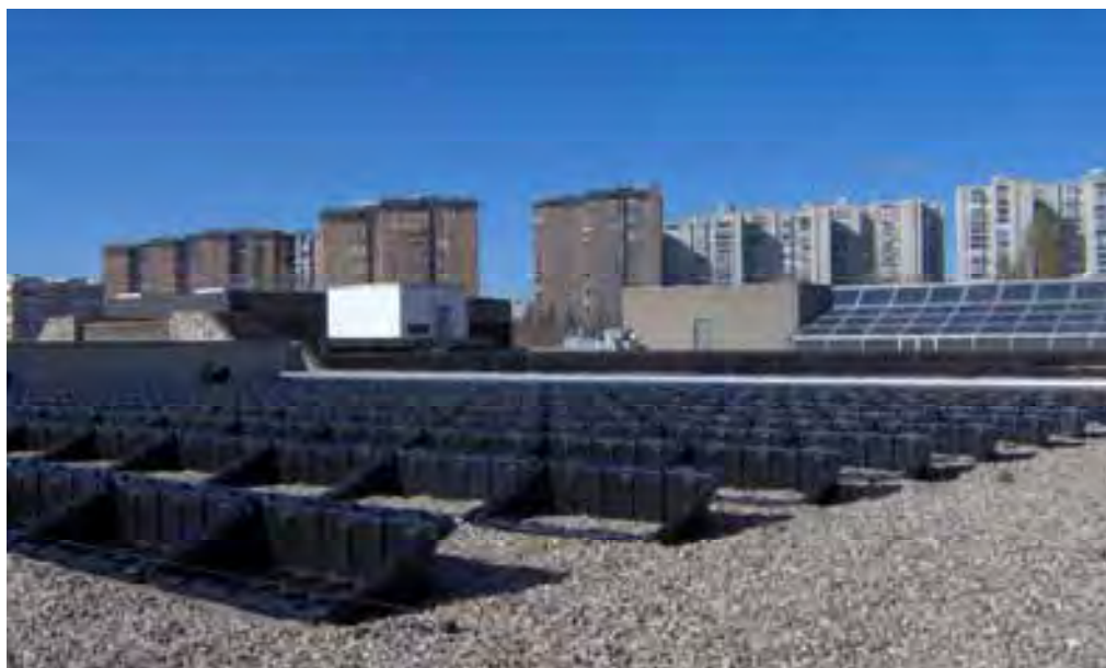
Foto 44. Estructuras de los módulos fotovoltaicos del campo nº 1.
