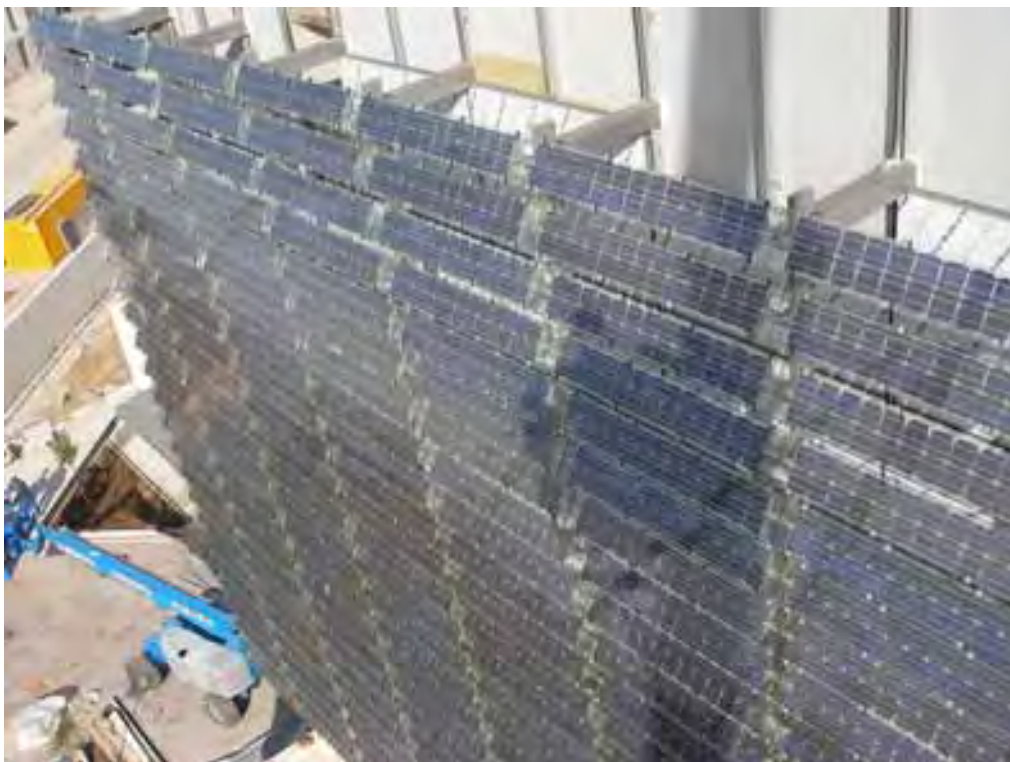
Foto 38. Lamas fotovoltaicas instaladas en el edificio del Proyecto Alzheimer.
