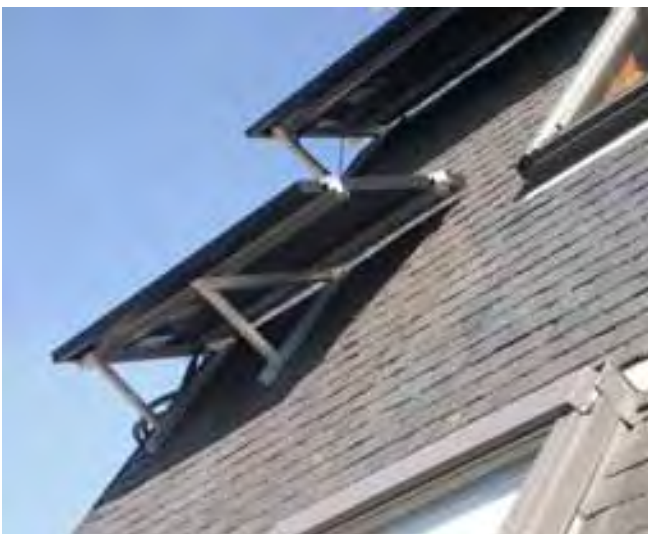
Foto 22. Instalación FV de 5,88 kWp en Villalba (Madrid).
