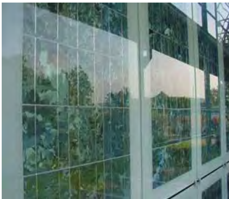
Foto 12. Fachada Fotovoltaica Verde del Polideportivo de Tübingen (Alemania) realizado por Conergy.
