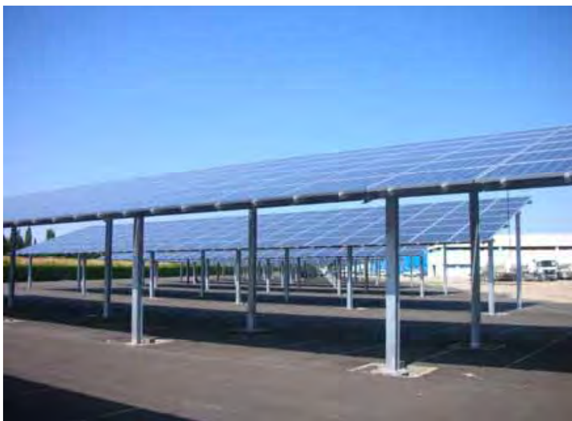
Foto 10. Instalación FV en estructura tipo parking en Zaragoza realizada por Conergy.
