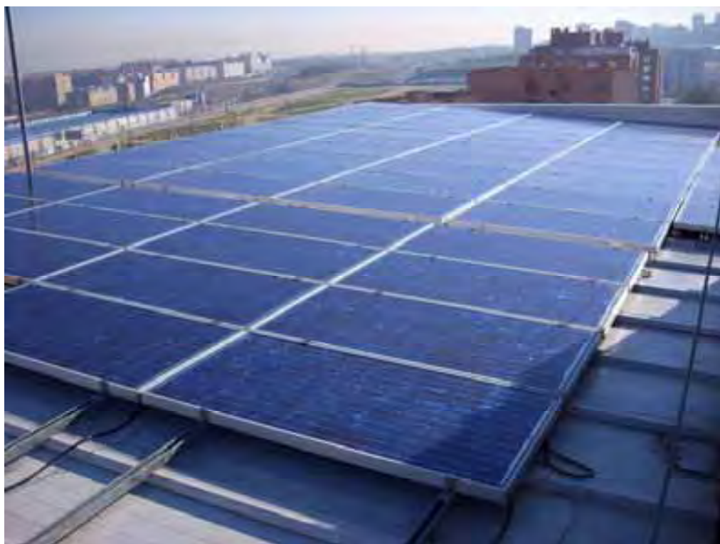
Foto 33. Instalación solar fotovoltaica del edificio Trasluz.
