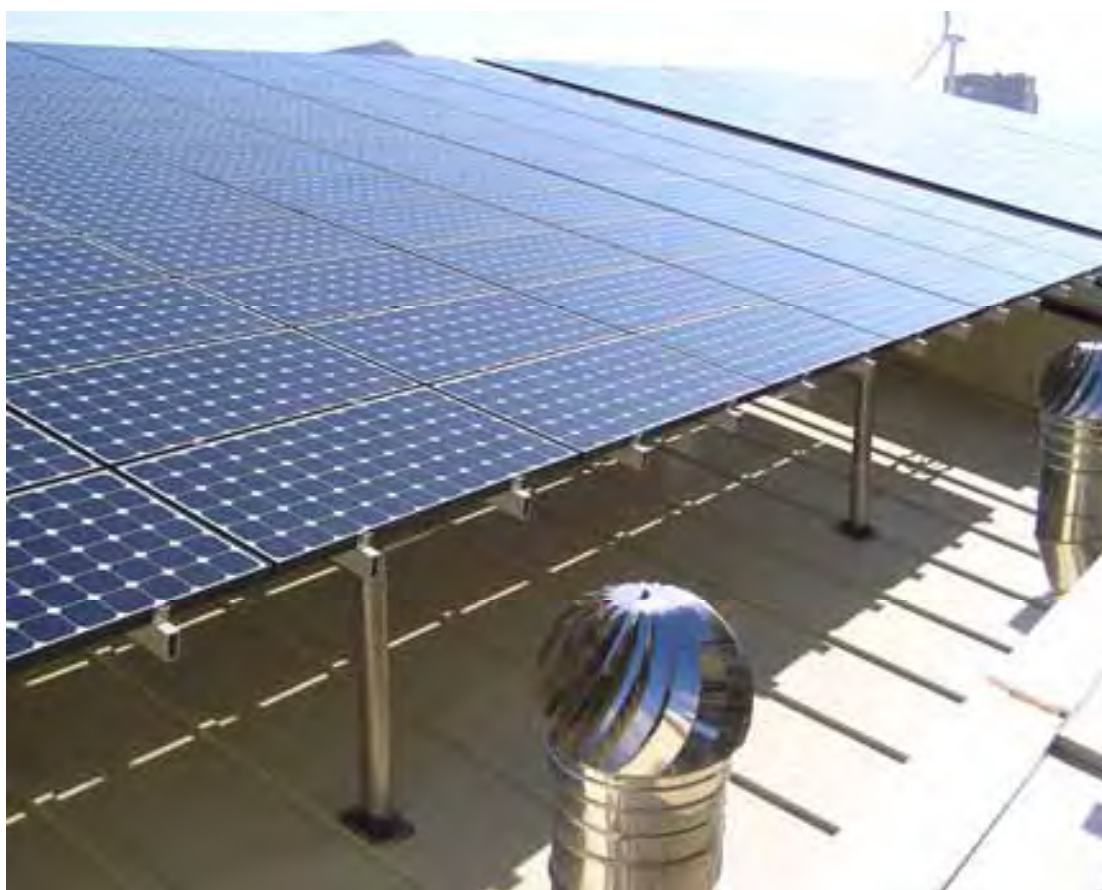
Foto 2. 181,44 kWp en Gran Canaria por Conergy. Módulos anclados al techo mediante estructura.
