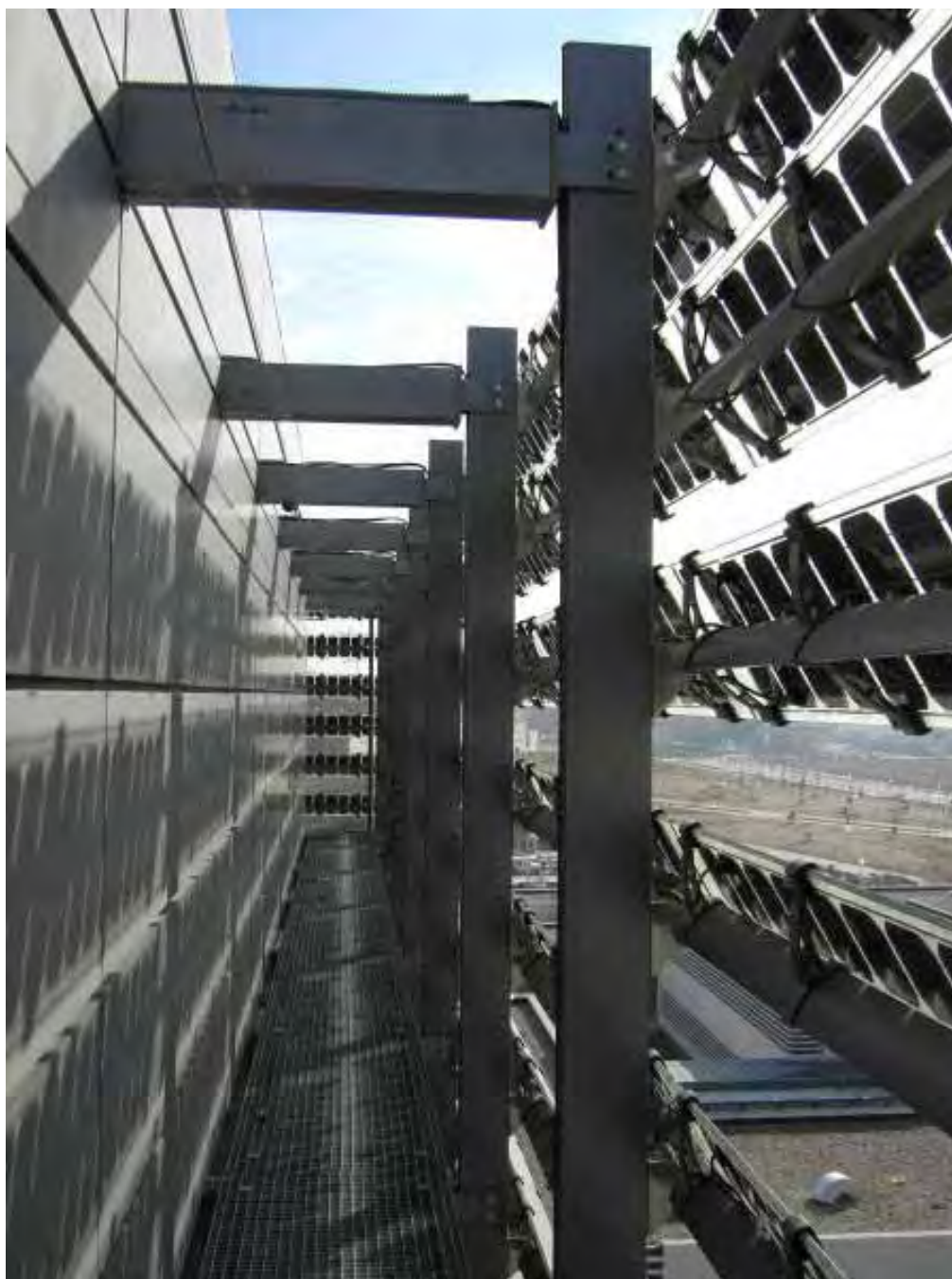
Foto 39. Montantes verticales para la fijación de las lamas fotovoltaicas.
