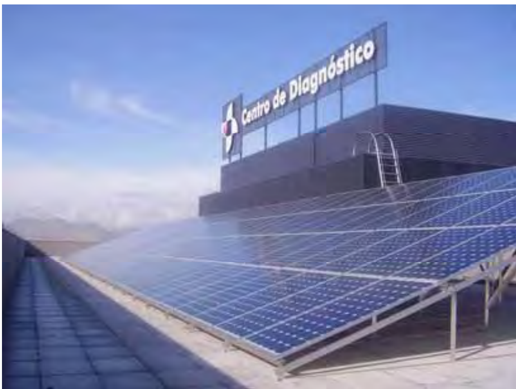
Foto 5. Instalación FV de 34,6 kWp en Granada de Conergy.
