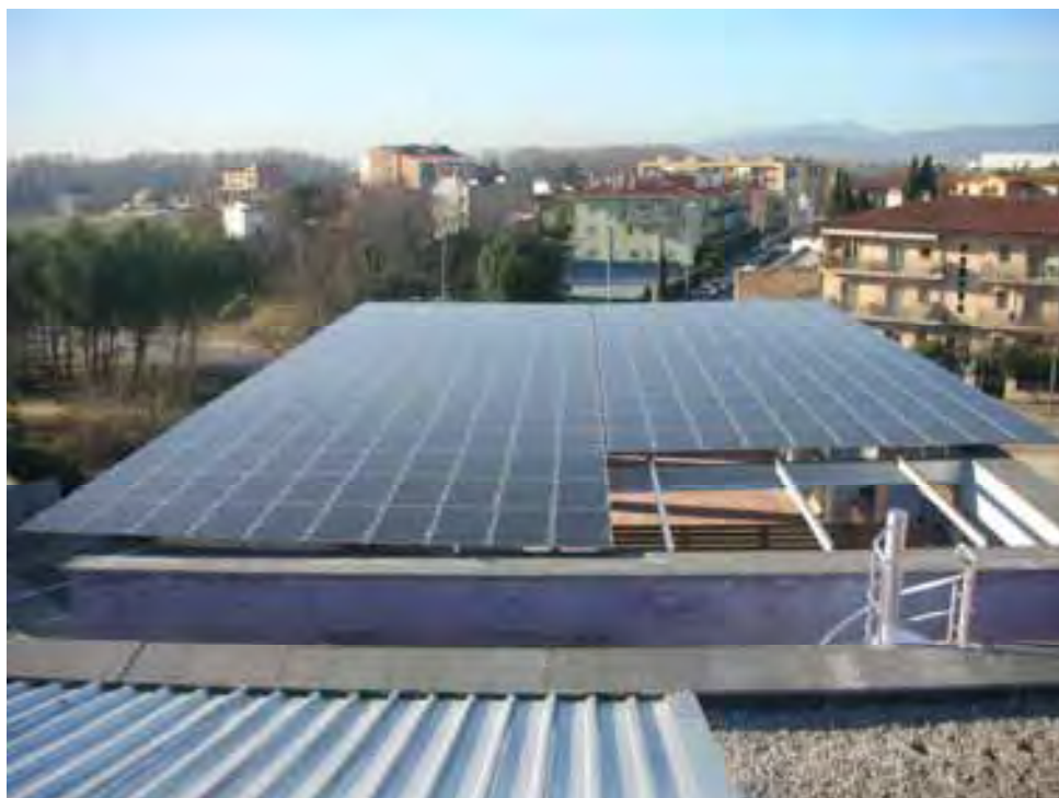
Foto 7. Instalación FV en Girona con módulos de capa fina.
