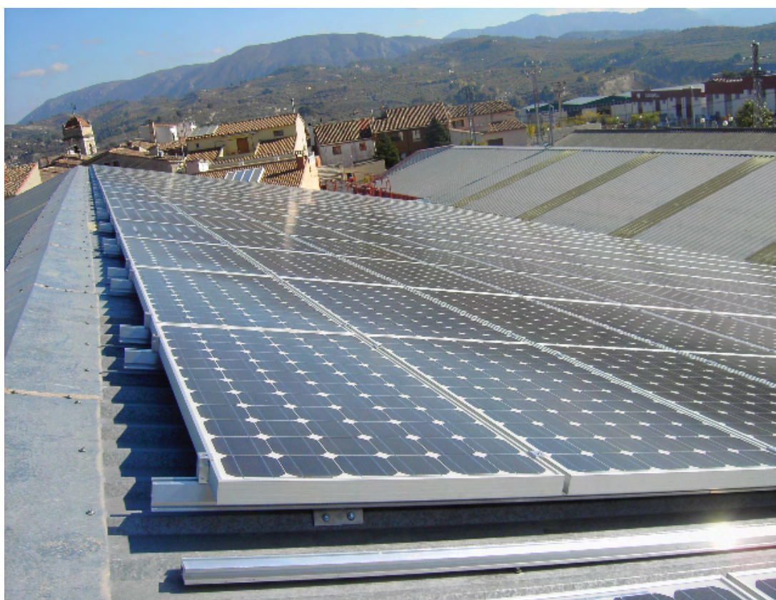
Foto 1. 94,8 kWp en Cocentaina (Alicante) realizada por Conergy- Enersol. Instalación realizada directamente sobre la cubierta.
