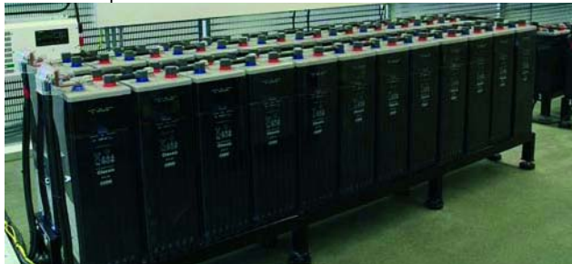
Figura 39. Baterías electroquímicas. Cortesía de LABEIN-TECNALIA.
