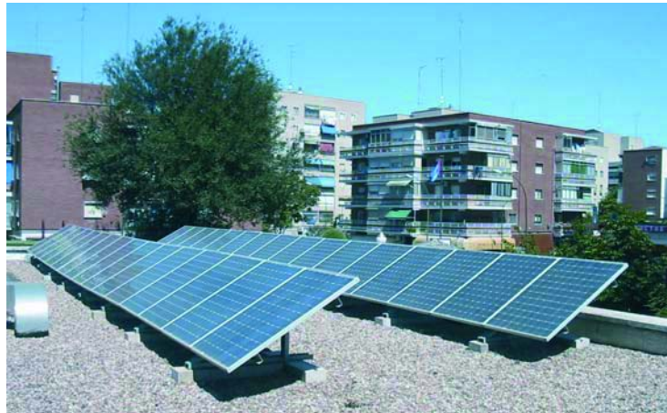
Figura 20. Paneles fotovoltaicos sobre edificios municipales en Móstoles.
